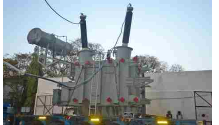
मेसर्स ट्रांसफार्मर्स एंड रेक्टिफायर्स लिमिटेड, अहमदाबाद के लिए उच्च शक्ति प्रयोगशाला, सी पी आर आई, बेंगलूर में 30.24 एम वी ए, 220/27 के वी एक कलीय संकर्षण परिणामित्र पर संपन्न लघु परिपथ परीक्षण के गतिक प्रभावों को सहन करने का सामर्थ्य ।
